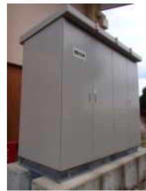
写真—蓄電池設備
