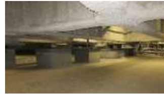
写真一 西棟 3 階の免震層
