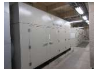
写真－別館に設置されているバックアップ電源
