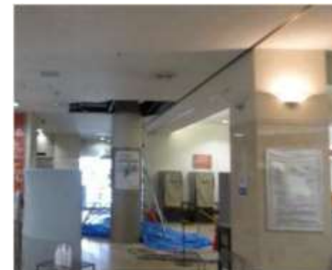
病院における天井の損傷
