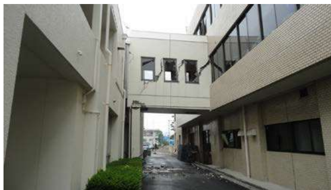
庁舎における構造部材の損傷
