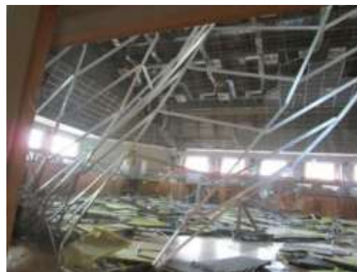
体育館における天井の損傷
