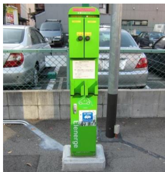
電気自動車等の充電設備
