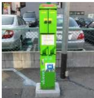
電気自動車等の充電設備
