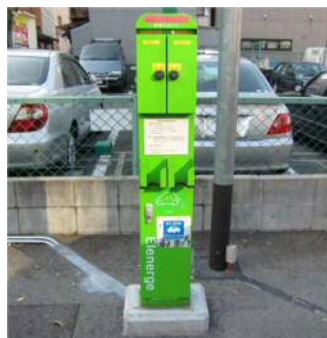
電気自動車等の充電設備
