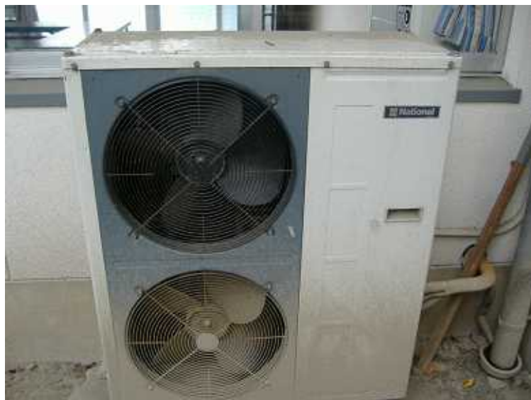
写真 2 8 集会室 床置エアコン室外機
