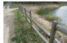
横木が欠落した防護柵
