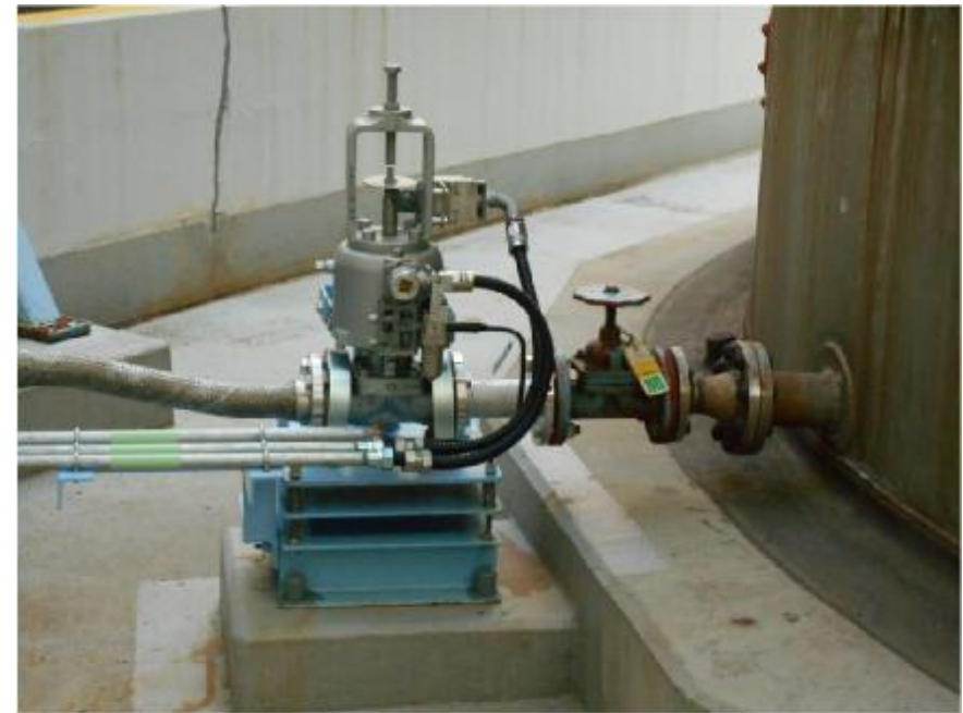
地震計と連動した緊急遮断弁
