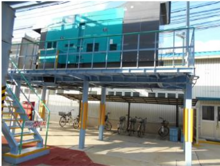
非常用自家 発電施設 (津波対策 で嵩上げ)
