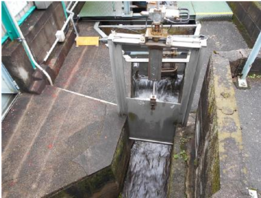
放流口を閉止する水門 (排水の監視設備を有し、漏洩時に感知して放流口を閉止)
