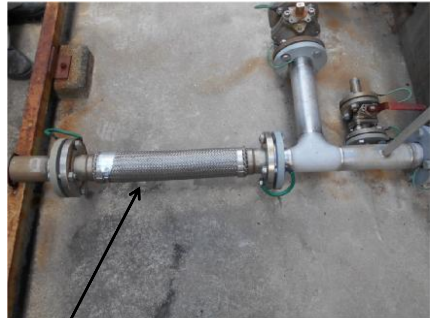
フレキシブル配管
