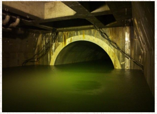
寝屋川南部地下河川(今川立坑貯留状況)H23.8
