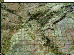
亀裂の発達状況
