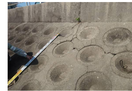
ブロックの陥没、護岸浮き
