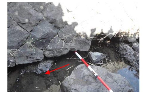
護岸下部の河床洗掘
