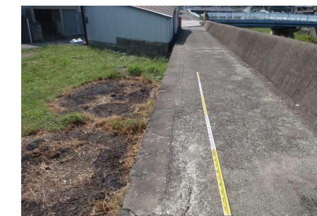
天端のクラック
