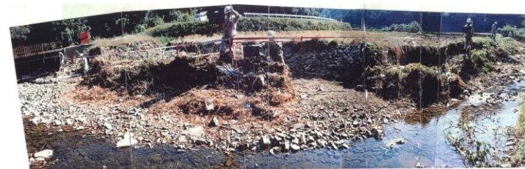
平成元年9月2～3日（豪雨） 普通河川東川右岸 護岸崩壊状況（延長110m） ※平成11年6月二級区間に編入
