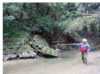
老朽化護岸(破損)
