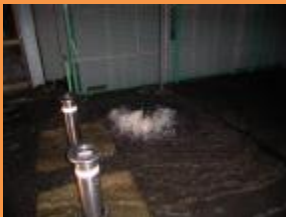
内水浸水状況
