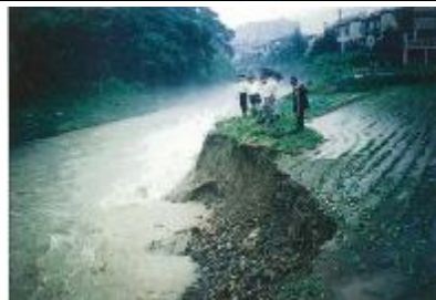
写真④ 平成7年7月2日~6日 近木川 千石橋下流右岸
