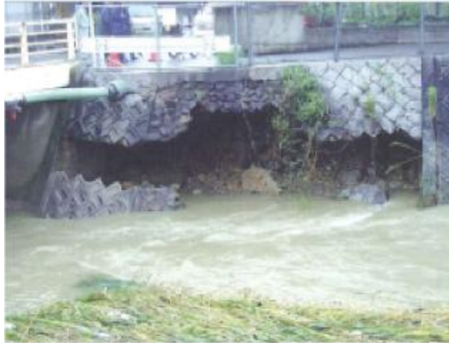
平成19年出水時 被災状況
