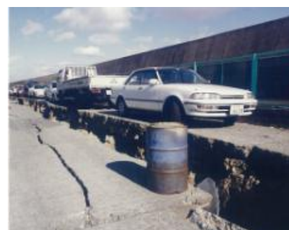
写真 1.2 防潮堤被災状況 (神崎川：神崎大橋上流右岸)
