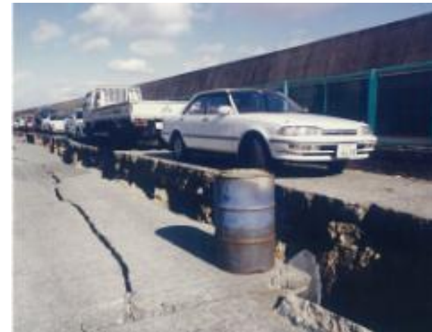
防潮堤被災写真 神崎川：神崎大橋上流右岸
