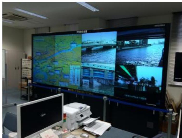
図 1.78 監視操作室表示盤（西大阪治水事務所）
