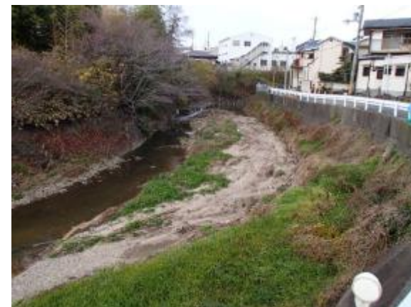
河道内の土砂堆積
