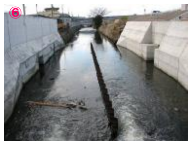
⑥ 落堀川（西橋より下流） コンクリートブロック護岸の河川で人工的な様相です。
