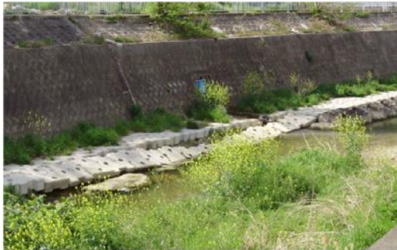
河床低下に伴う根固めブロックの不陸
