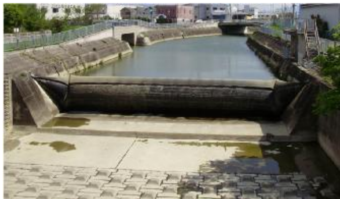
取水堰の段差が大きく、移動に影響をあたえている。
