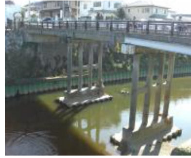
図 1.13 河床低下の状況 (橋脚の基礎部が露呈)
