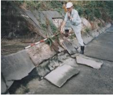
図 1.12 老朽化護岸の状況
