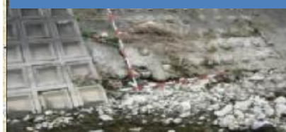
護岸の老朽化（牛滝川）
