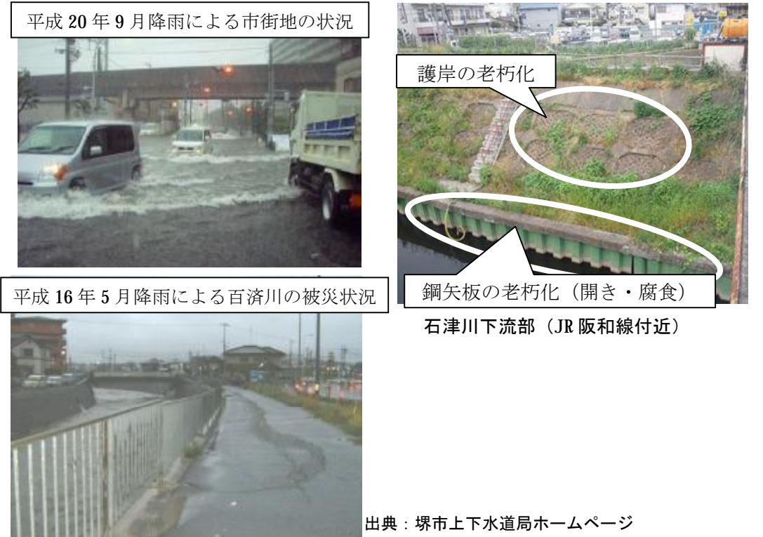
図 1.2.2 過去の被災状況
