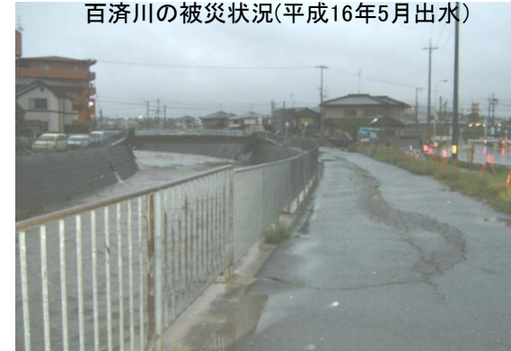
百済川の被災状況(平成16年5月出水)
