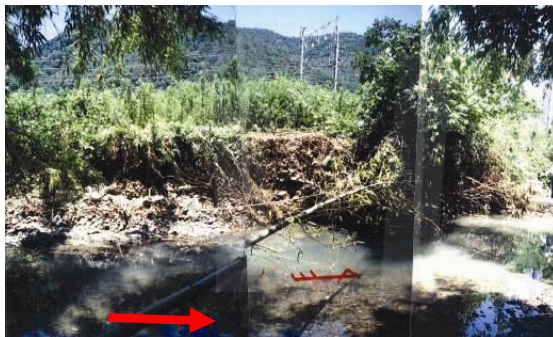
⑤平成7年豪雨被災写真 (柳池川合流点下流)
