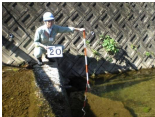
河川施設点検(河床の低下)
