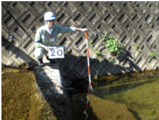
図2.7 河川施設点検 (河床の低下)
