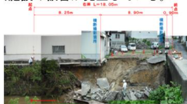
平成23年度 松尾川(冬堂橋下流右岸被災状況)
