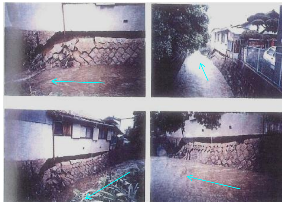
(平成7年5月豪雨状況:前川砂子橋上流)
