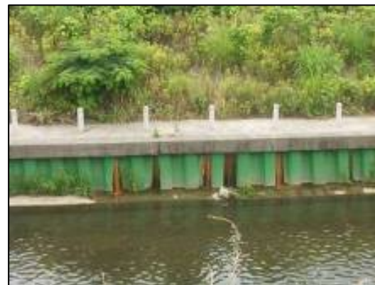
低水路部鋼矢板の破損状況
