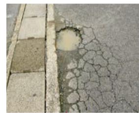
損傷例(路面の穴ぼこ)
