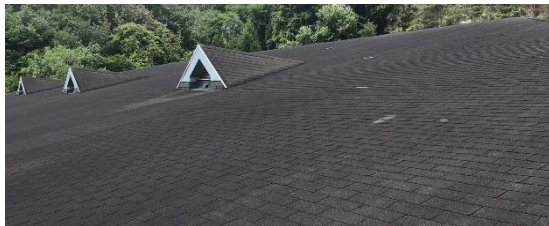
雨漏りが発生する屋根
