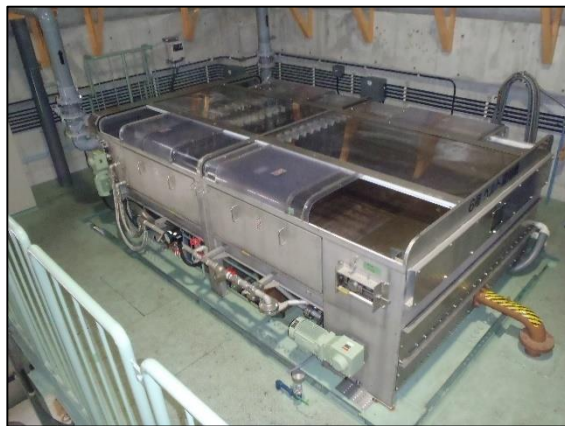
汚泥濃縮機(渚水みらいセンター)
