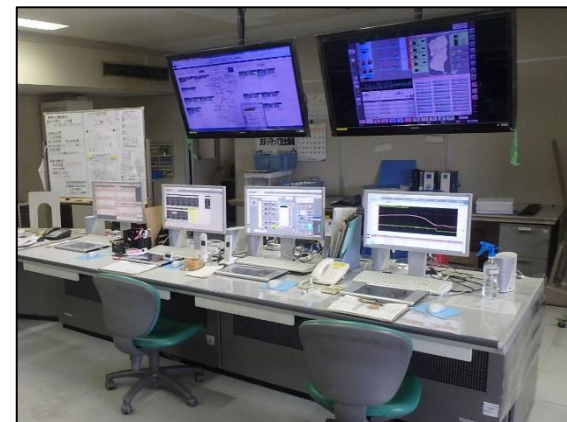
監視制御設備(川俣水みらいセンター)
