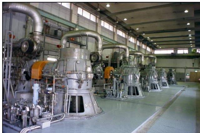
雨水ポンプ(小阪ポンプ場)
