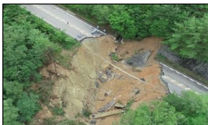
道路のり面の崩壊(R173:H30集中豪雨)
