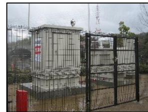
非常用発電設備
