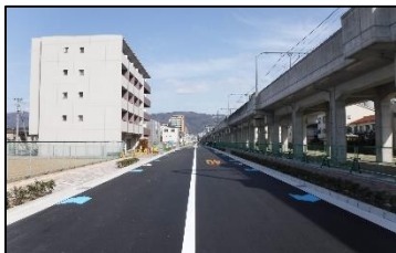
新設道路における歩行空間や 自転車通行空間、無電柱化の設置例
