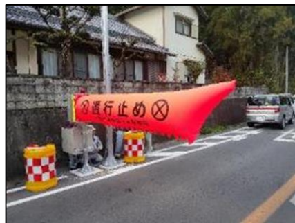
空気式遮断機による通行規制
