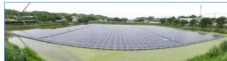
岸和田市傍示池の太陽光発電設備(ドリームソーラーフロート1号@神於山)
