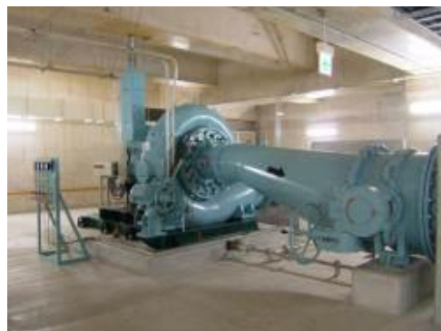
長居水力発電設備
