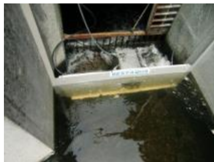
南部水みらいセンター（泉南市）
