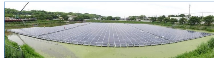
岸和田市傍示池の太陽光発電設備(ドリームソーラーフロート1号@神於山)
