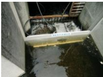
南部水みらいセンター（泉南市）
