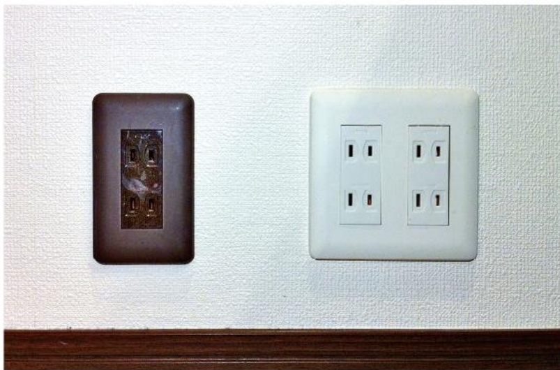
非常用コンセント (屋外設置パワーコンディショナの例)
