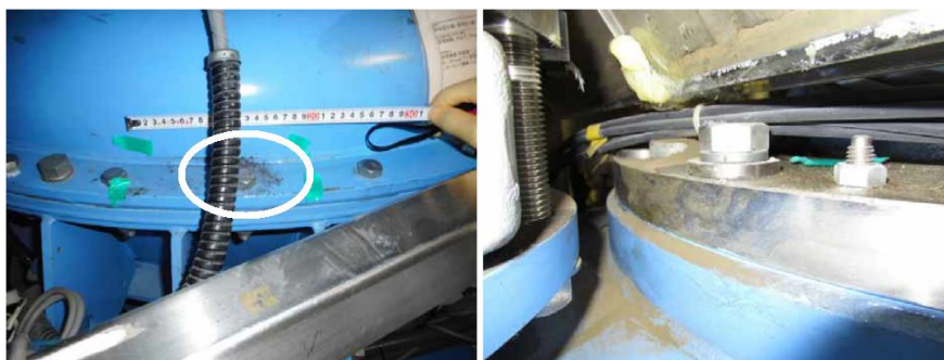
図 I-4 酸化ウラン粉末の漏えい状況
