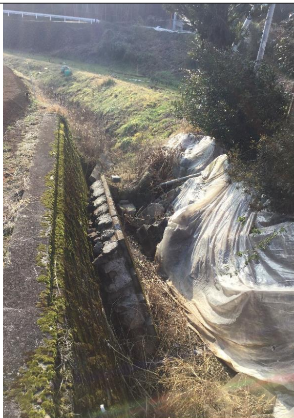
443-2077 水路 被災状況
