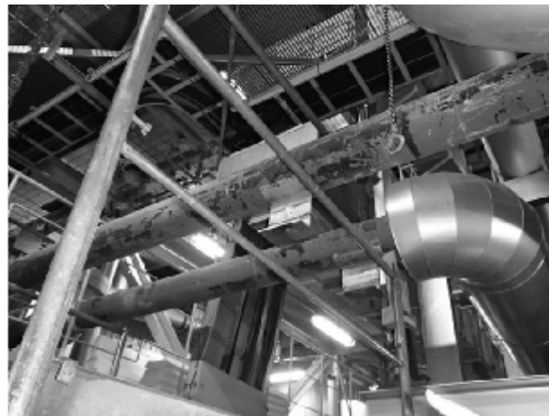
吹田市（配管脱落）
