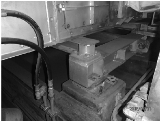
箕面市（ボルト破損）
