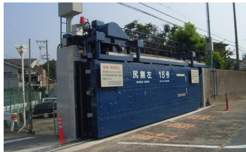
【鉄扉の電動化】平成26年度完了
