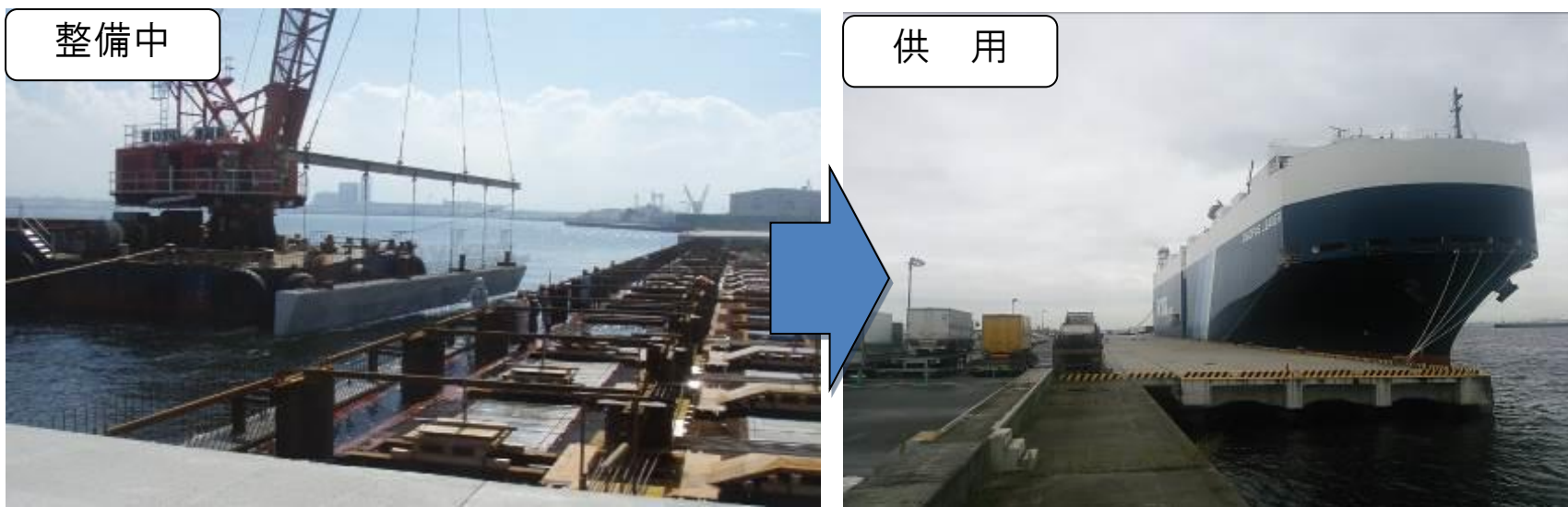
図 岸壁の整備イメージ（夕凧1号岸壁（堺泉北港汐見沖地区） 泉大津市）
