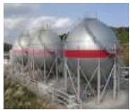
液体水素タンク
