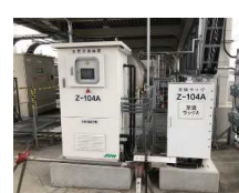
水素充填 ユニット
