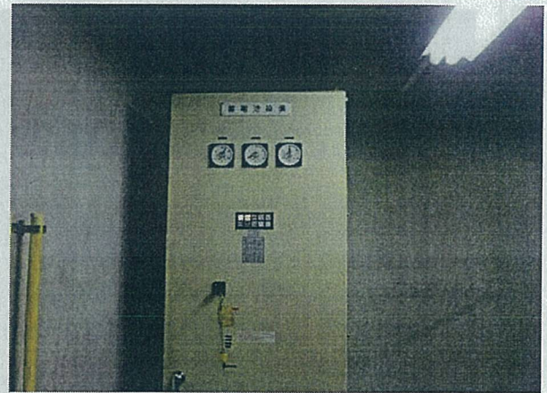
E 04 B1階 蓄電池盤 外観 蓄電池設備 書庫
