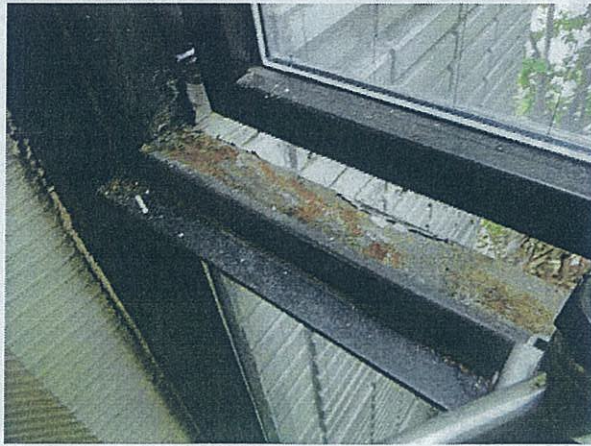
A 07 外部建具 漏水による腐食状況 スチールサッシ —
