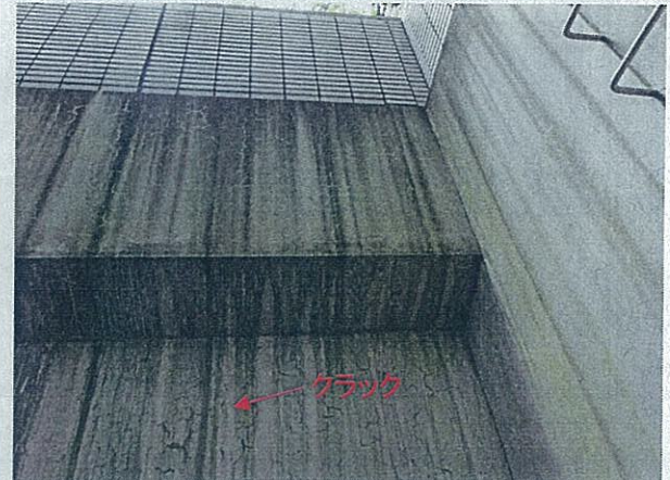
A 05 外壁 クラック
