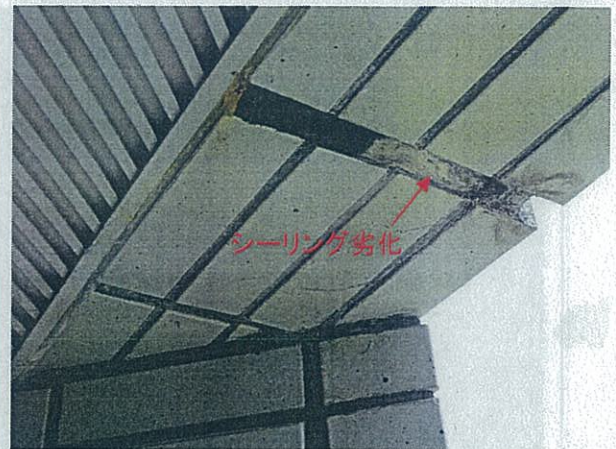
A 06 外壁 目地シール・建具廻りシールの劣化
