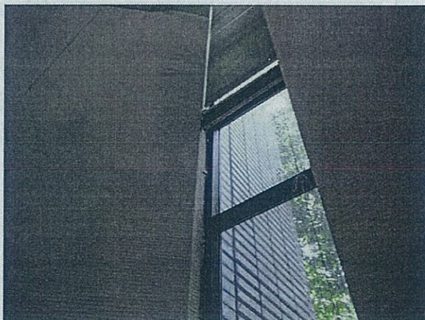
A 07 外部建具 目地シール・建具廻りシールの劣化 内壁に漏水跡有
