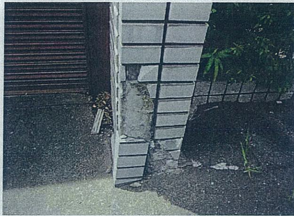
A 05 外壁 外壁タイル破損部
