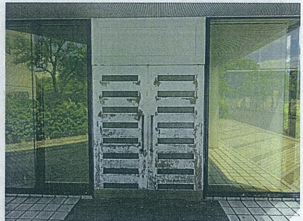
A 08 外部建具 木製建具塗装剥離 木製建具 食堂入口
