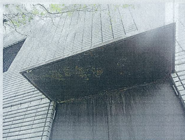
A 09 その他 庇錆 庇
