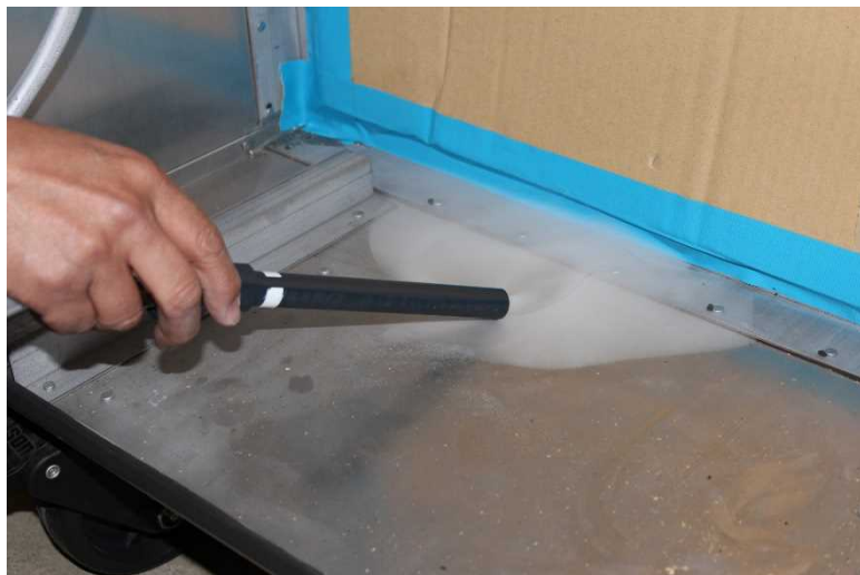
スモークテスターによる漏れの確認 HEPAフィルタ取り付け面の隙間から煙が吸い込まれていく
