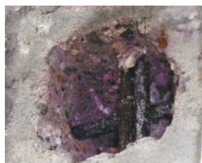
(4 階 W5: 中性化深さが壁筋に到達)
