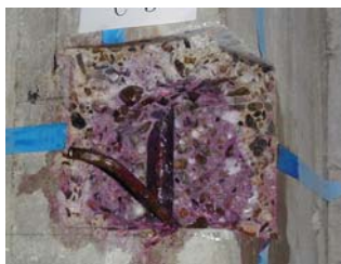
(3 階柱 C: 中性化深さが帯筋に到達)
