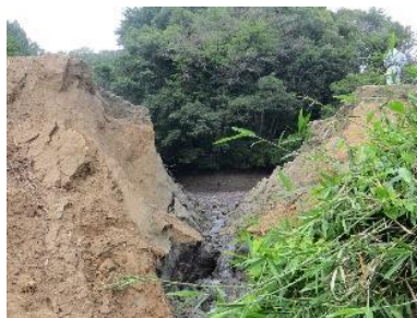
平成 30 年 7 月豪雨による堤体の決壊（下蓮池：八尾市）
