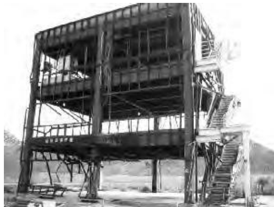
写真7：震災後の防災庁舎
