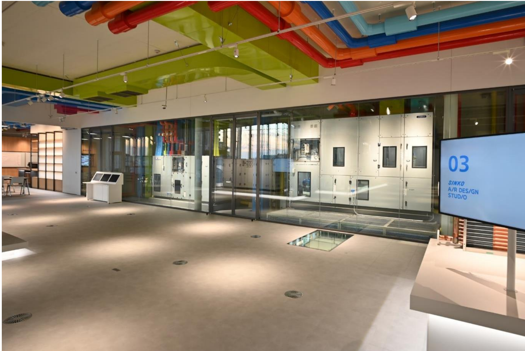
ガラス張りの体感型機械室 系統毎に色分けされた配管・ダクト
